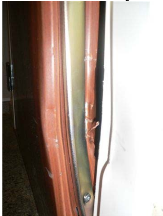
Dörrens nederkant, intakt hakregellås.
